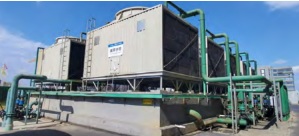
广东基地循环水塔：冷却水循环总量 2830 立方米每小时 节水率大于 10%
